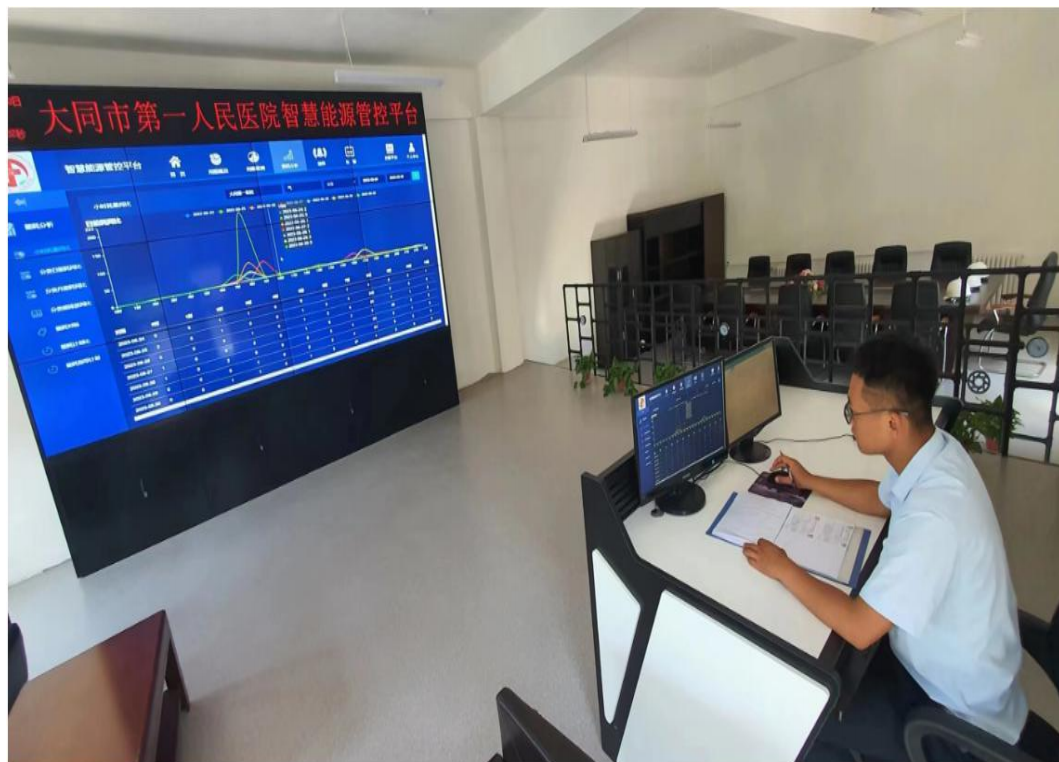
实时监控机房，保证安全运行
